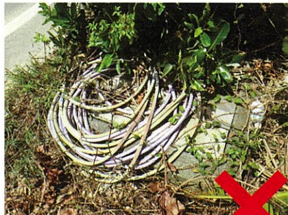
ボックスの上にホースが置いてありフタをあけることができません
