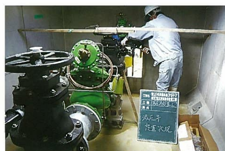
減圧弁設置状況
