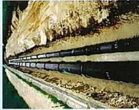
(右) 東山1号送水路、直径 700mm (左) 東山1号幹線水路、直径 1200mm
